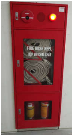
Hệ thống chữa cháy vách tường/ Water Spray System
