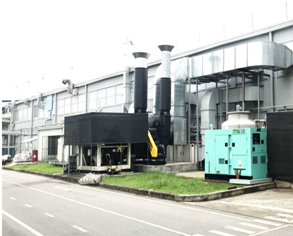
EXHAUST FAN FOR FACTORY
