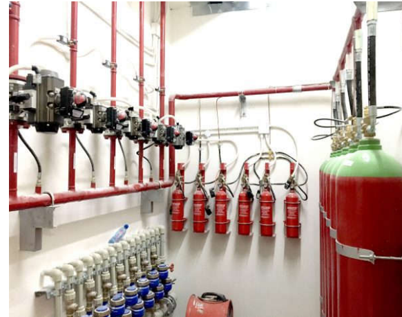
Hệ thống chữa cháy bằng khí Ni- tơ/ Nitrogen (N 2 ) Fire Extinguishing System
